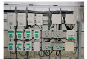
図5 ハウス内の多数の制御盤
